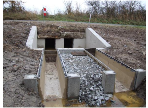
Installation d'un piège à poissons chats
